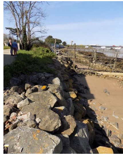
Enrochements abrupts ayant tendance à tomber, Saint-Brévin-les-Pins
