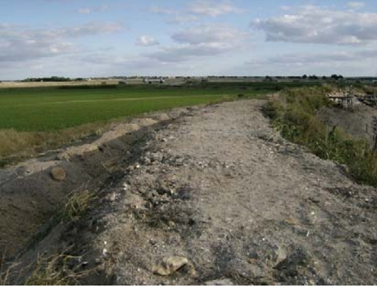
Matériau peu adapté, travaux sans maîtrise d'œuvre, Bouin
