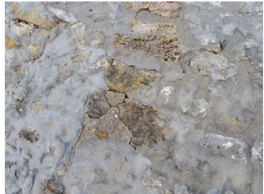
Mauvaise qualité du rejointoiement, Noirmoutier
