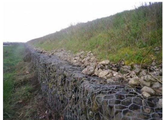
Matériaux hétérogènes, la Faute-sur-Mer
