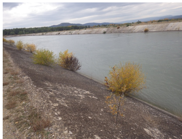
FIGURE 4 : COLONISATION DES BAJEYERS EN BETON PAR LES PEUPLIERS
