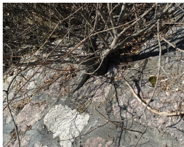
FIGURE 1 : DESTRUCTURATION EN COURS D'UN PIERRE MAÇONNE PAR UN PEUPLIER AYANT ETE RECEPE PLUSIEURS FOIS
