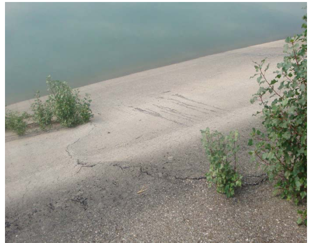
FIGURE 3 : APPARITION DE NOMBREUX DRAGEONS LE LONG D'UNE FISSURE GENEREE PAR UNE RACINE TRAÇANTE SUITE A L'ABATTAGE DE L'ARBRE MERE
