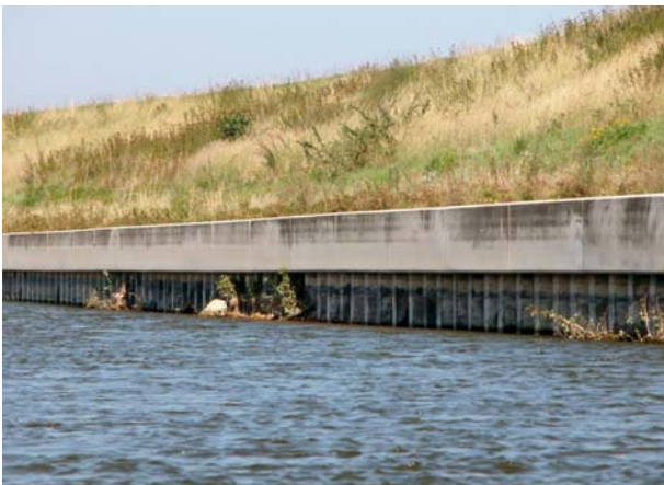
FIGURE 8: PROTECTION DE PIED DE DIGUE PAR PALPLANCHES LIAISONNEES EN TETE PAR UNE LONGRINE EN BETON (ST BENOIT-SUR-LOIRE, 45) (CREDIT DREAL CENTRE VAL DE LOIRE)
