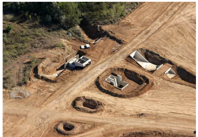
PHOTO 7 : OUVRAGES DE GESTION HYDRAULIQUE TRAVERSANT ET DE POMPAGE AVANT ELEVATION DE LA DIGUE (©BRLi)
