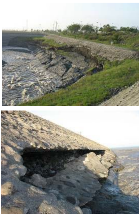
FIGURES 9 ET 10 : DESTRUCTION RD DIGUE ENTRE EPIS ET SOUS-CAVEMENT ENDIGUEMENT RG AVAL
