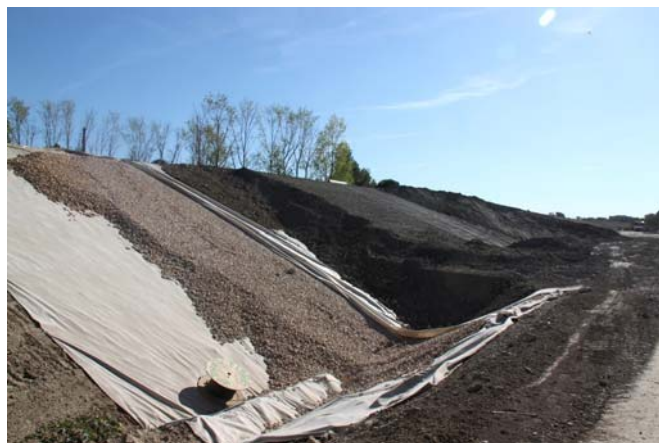
FIGURE 1 : COUPE TYPE ET PHOTO – TRONÇON NON RESISTANT A LA SURVERSE
