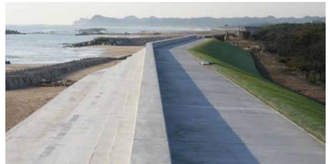
FIGURE 9 : DIGUE RESISTANT AUX TSUNAMIS, COURTESY : KAJIMA CORP.
