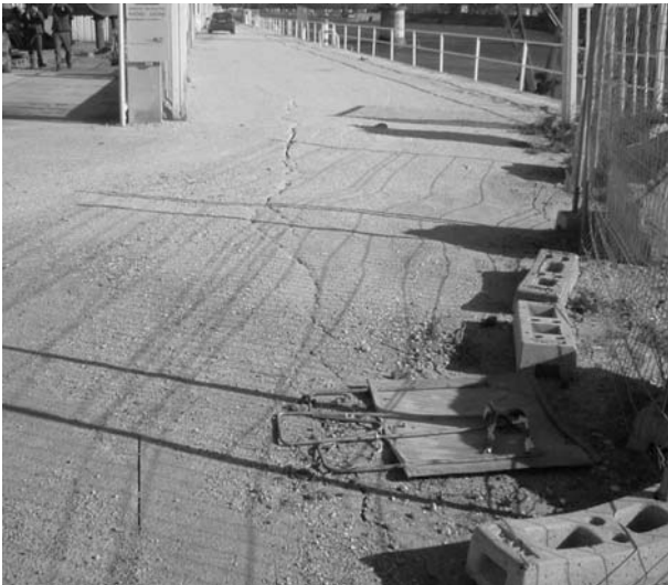
FIGURE 21 : FISSURATION DU TERRE-PLEIN
