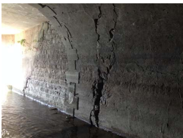
FIGURE 10 : FISSURATION DES OUVRAGES TRAVERSANTS
