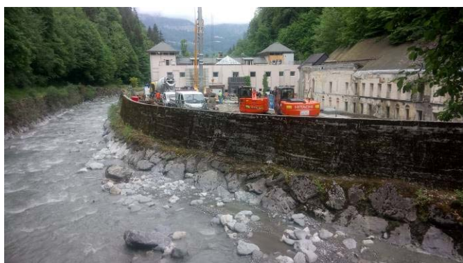
FIGURE 4: DIGUE DES THERMES DE SAINT GERVAIS LE LONG DU BONNANT
