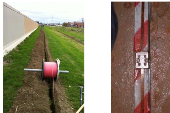
FIGURE 6 : INSTALLATION CABLE DE MESURE DE DEFORMATION, DE GAUCHE A DROITE : DIGUE PROJET ILEVEE A LA NOUVELLE-ORLEANS (USA) - CABLE ENTERRE, GALERIE DU BARRAGE PLAVINU HES (LETONNIE) - RAINURAGE SUR BETON
