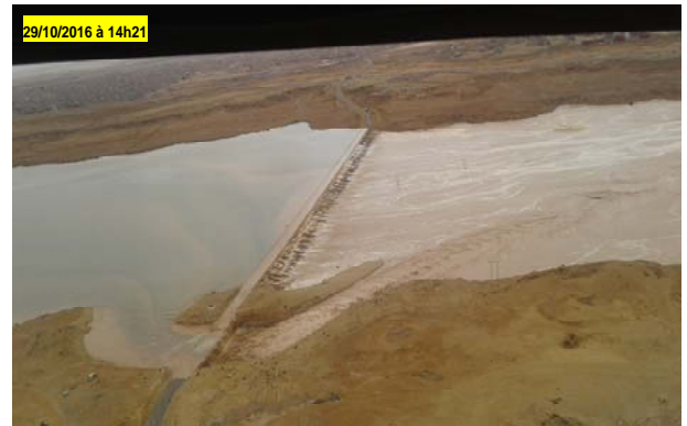
FIGURE 4 : SURVERSE AVANT RUPTURE DU BARRAGE SH
