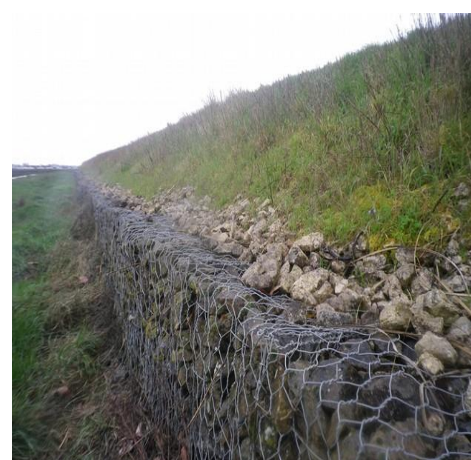
Matériaux hétérogènes - Crédit : DREAL Pays de la Loire
