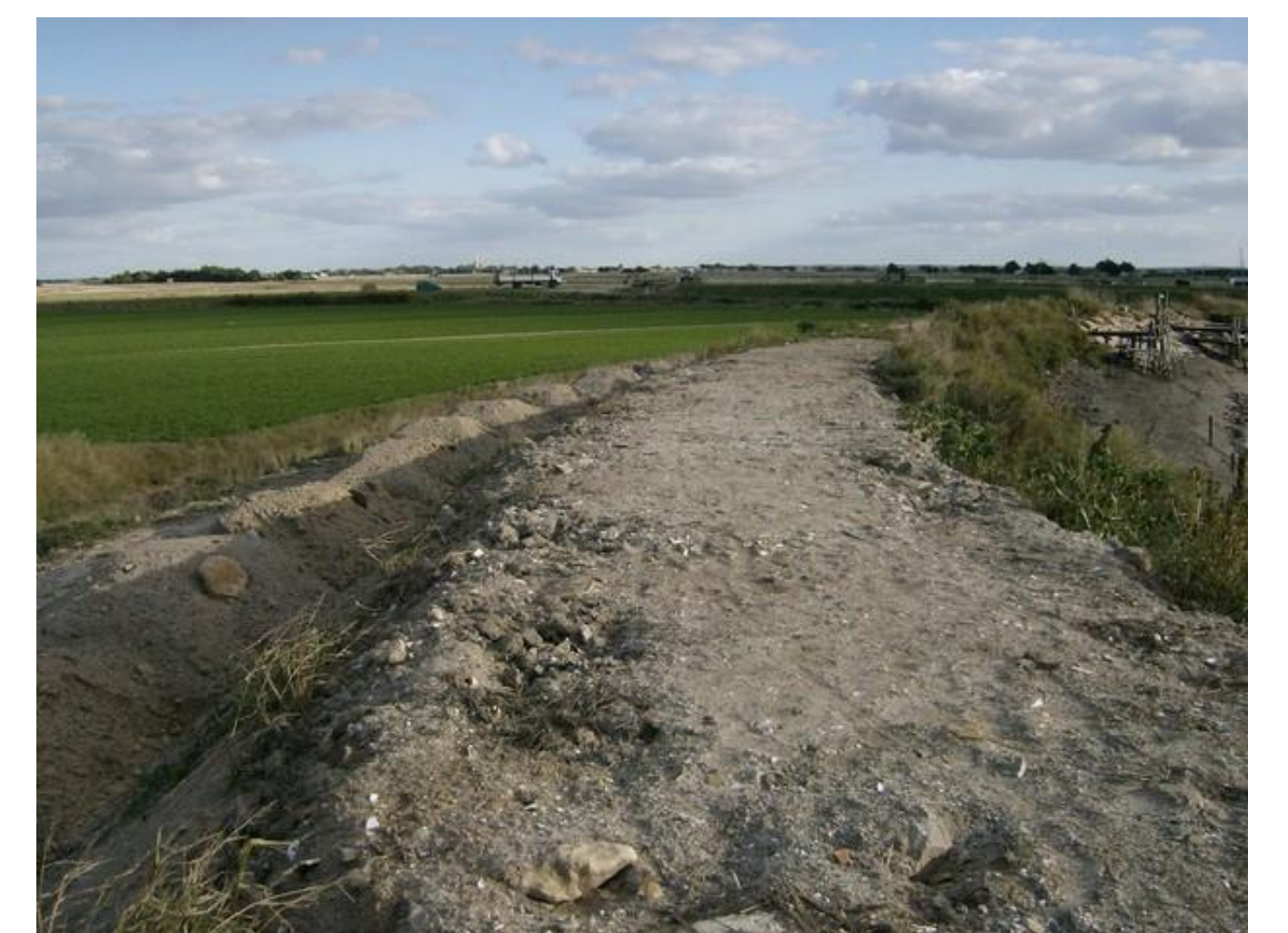
Matériaux non adaptés à une digue - Crédit : DREAL Pays de la Loire
